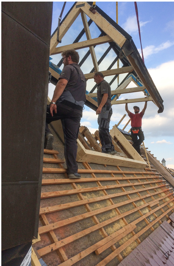
Die Firstverglasungen wurden vorgefertigt auf die Baustelle geliefert und mussten nach Denkmalschutzvorschriften dachflächenbündig eingebaut werden.
